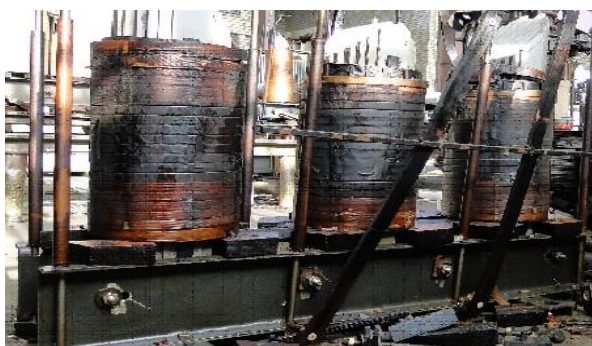
شکل (۷): فروپاشی کامل عایقی ترانسفورماتور
