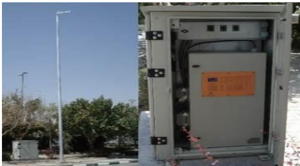
شکل ۸: نمایی از یک RTU نصب شده در یک پست زمینی و یک RMU
