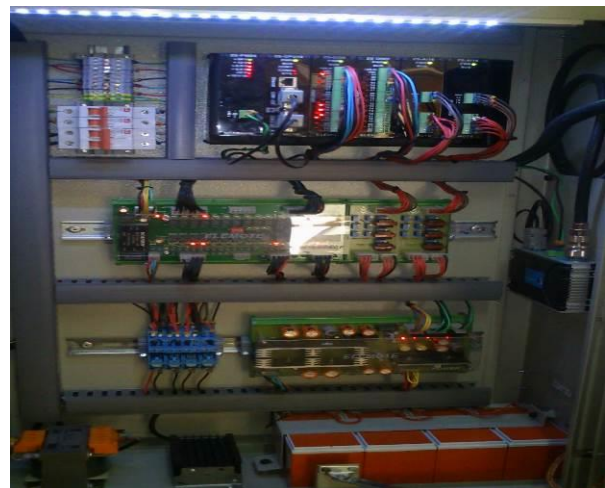
شکل ۶: نمای داخلی RTU
